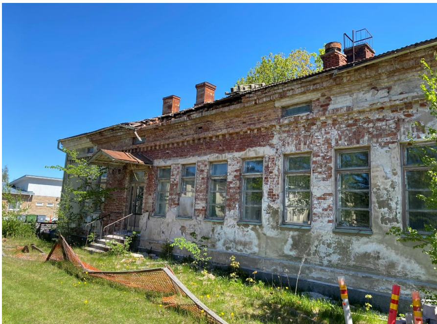
Kuva 11. Läntisen puolen julkisivu ja irtoillut rappaus.
