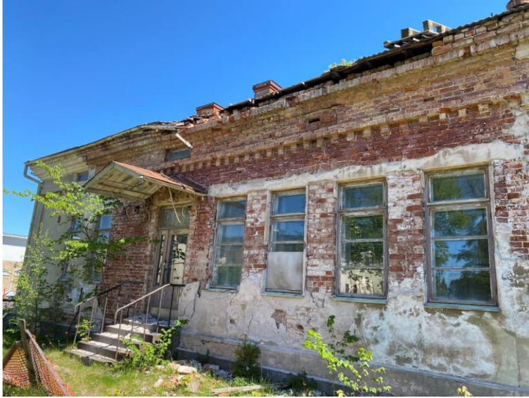
Kuva 6. Pahasti vaurioitunut räystäärakenne
