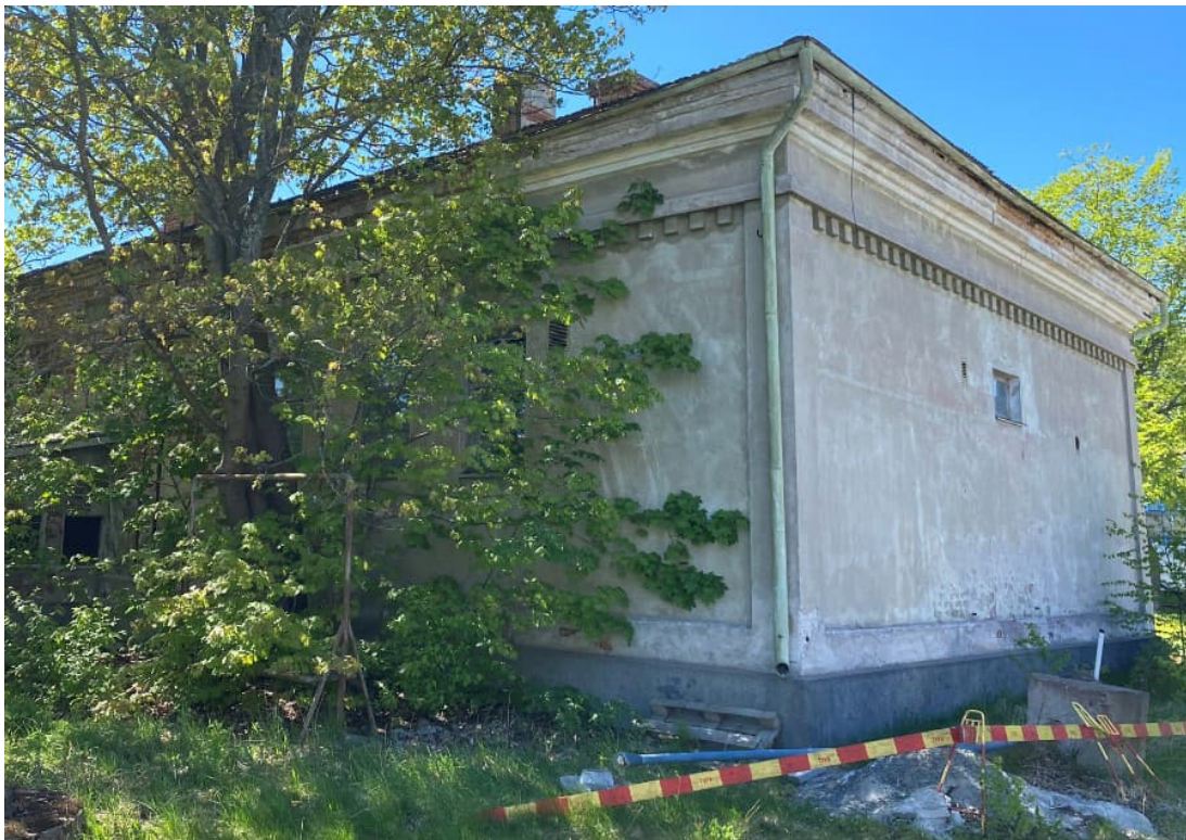
Kuva 12. Rakennuksen varjoisilla puolilla julkisivut ovat pintapuolisesti kohtuullisessa kunnossa. Kuvassa näkyy myös hammaskoristeinen kerroslista.
