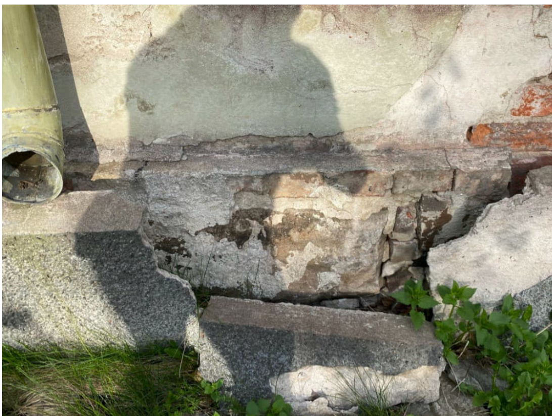
Kuva 8. Kivijalasta irronnut tasoite- ja rappauskerros.
