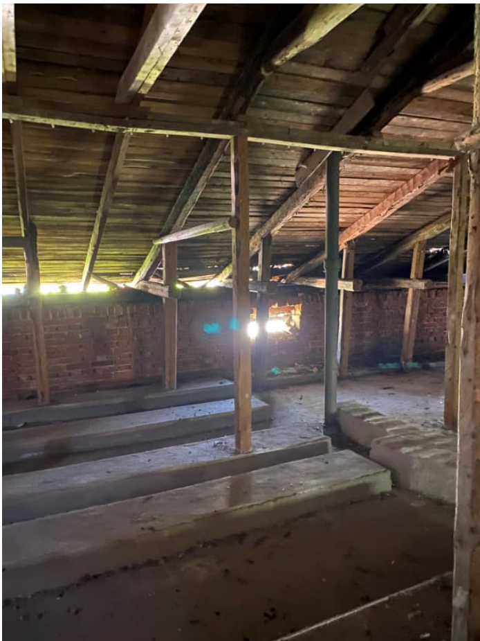
Kuva 7. Kosteus- ja mikrobivaurioitunut vesikaton puurunko.
