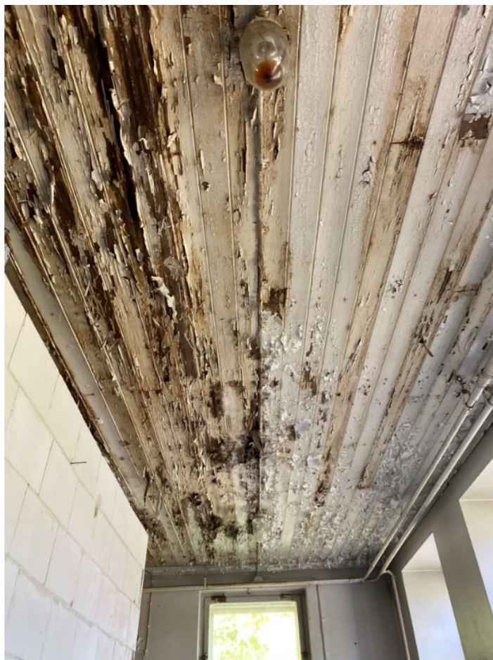
Kuva 18. Kuivaus- ja silityshuoneen kärsinyt kattorakenne.
