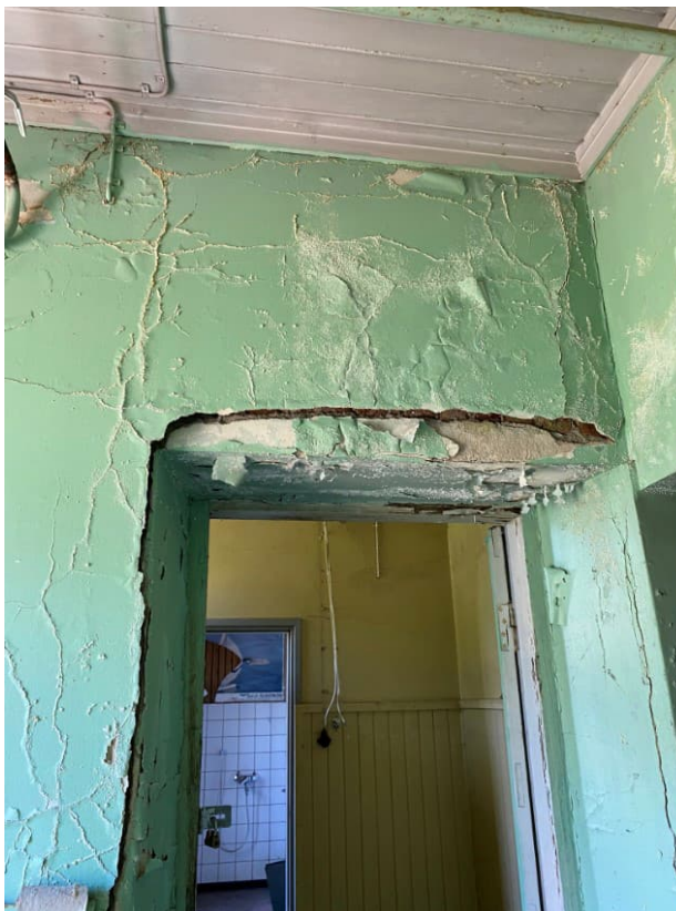
Kuva 17. Eteistilan irronneet rappaukset.
