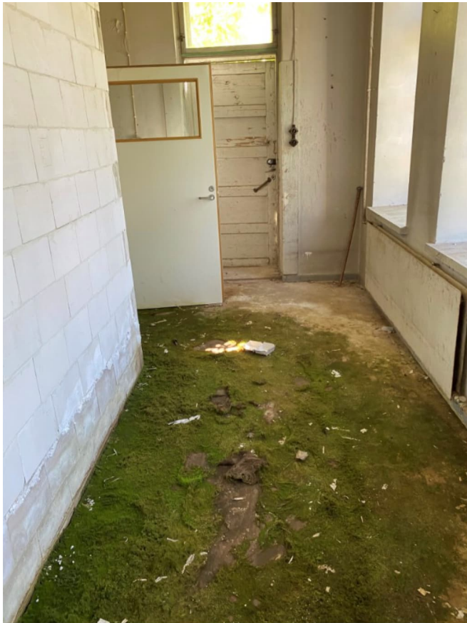
Kuva 9. Sammalkasvustoa betonilaatan päällä.
