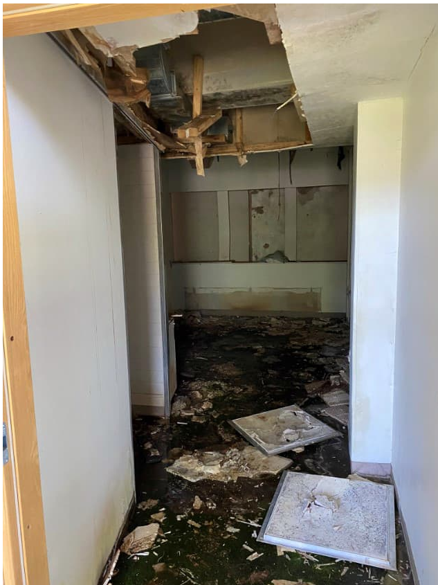
Kuva 10. Sammal- ja mikrobikasvustoa oli rakennuksen sisällä useissa paikoissa.
